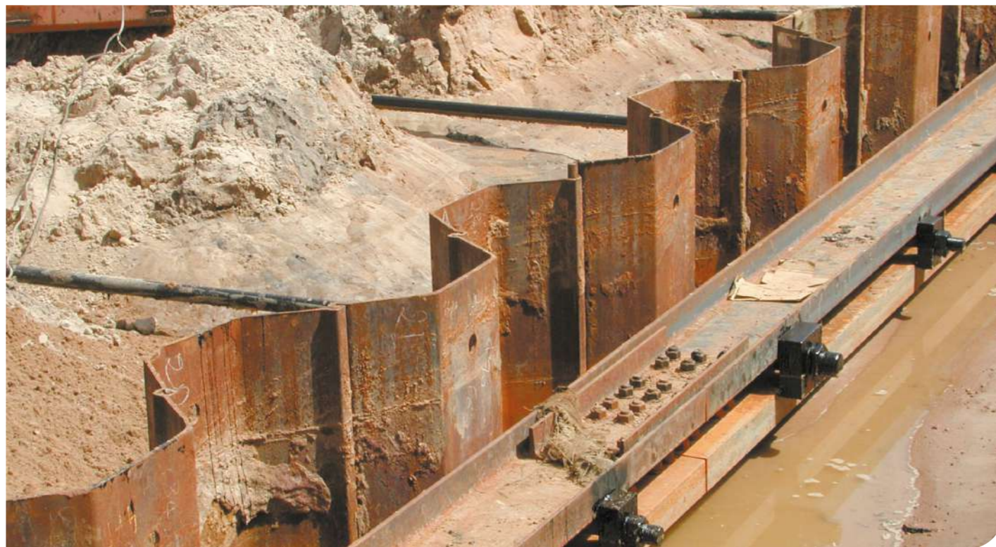
Sistema de Ancoragem
